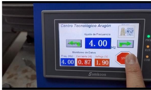
Figura 13 - Verificación del botón STOP.
